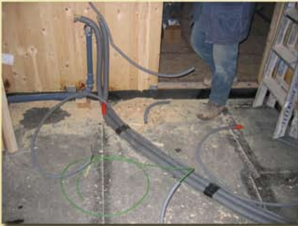
Kabelführung im Fussbodenbereich
