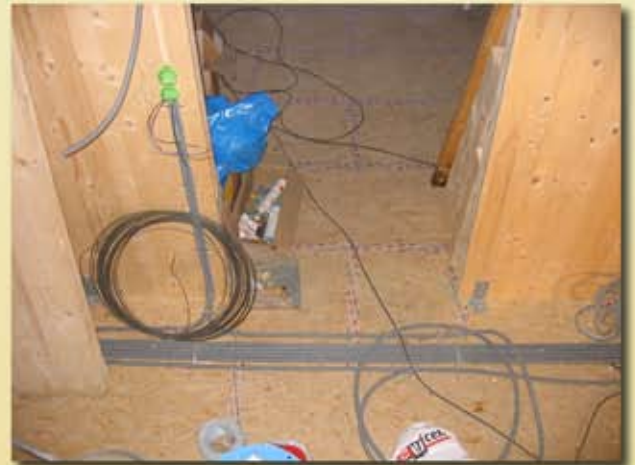
Kabelführung im Fussbodenbereich
