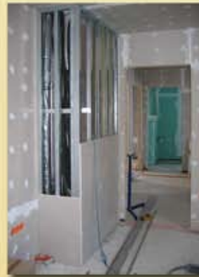
Vorsatzschale Installationsebene beim Kamin.
