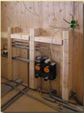
Anschluss Waschbecken Bad.
