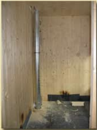
geflämte "Wanne" im Bad u. kontrollierte Wohnraumlüftung
